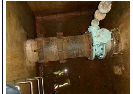
<유입밸브실 2지 배관, 볼트류 부식>
