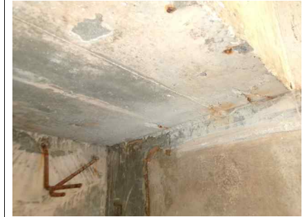
<유입밸브실 2지 상부슬래브 철근노출>
