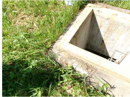
<유입밸브실 1지 입구 파손>
