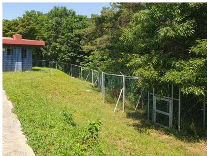
<부대시설 안전펜스 상태현황>
