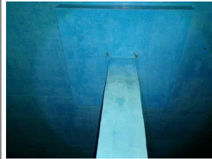
<배수지 2지 상부슬래브 녹>
