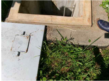
<유입밸브실 1지 입구 파손>
