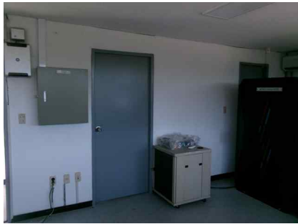
<전력 배전반 및 전기설비 상태양호>
