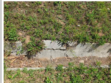
<부대시설 배수지 장내 배수로 파손>
