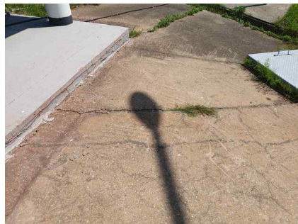
<부대시설 배수지 장내 포장균열>
