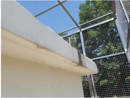
<계단실 외부 상부슬래브 파손>
