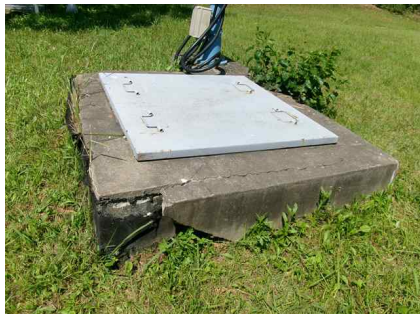
<유출밸브실 1지 입구 파손>
