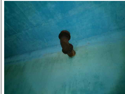
<배수지 2지 유입배관, 볼트류 부식>
