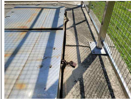
<부대시설 장내 배수지 상부 파손>
