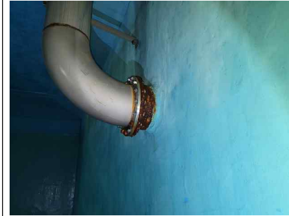
<배수지 1지 유입배관, 볼트류 부식>
