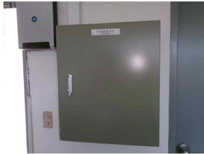
<전기실 작업용분전반 상태양호>
