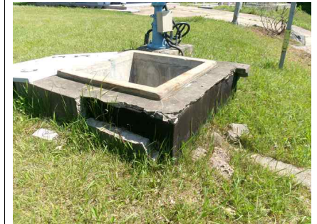
<유출밸브실 2지 입구 파손>
