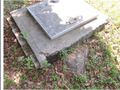
<유입밸브실 2지 입구 파손>
