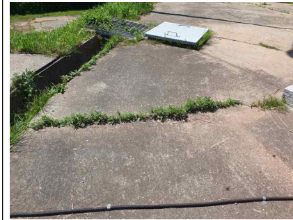
<부대시설 배수지 장내 포장균열>
