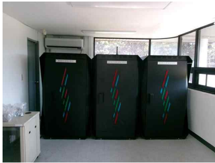
<전기실 전기설비 상태양호>
