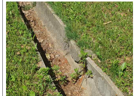
<부대시설 장내 배수로 파손>
