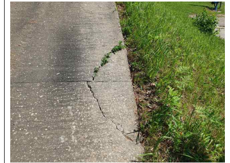
<부대시설 배수지 장내 포장파손>
