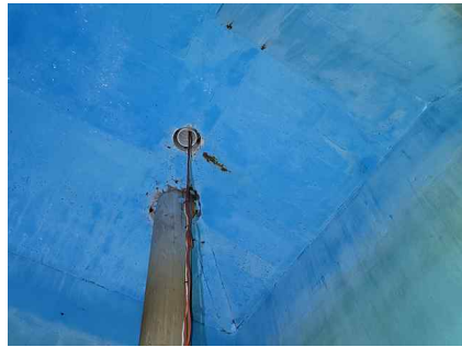
<배수지 1지 상부슬래브 철근노출>
