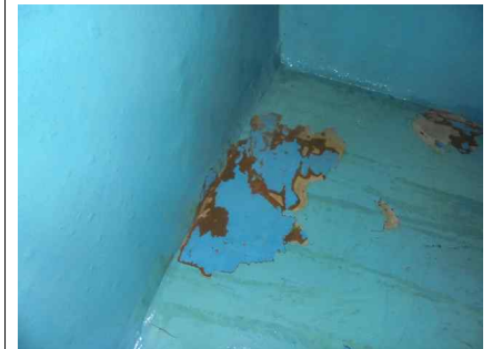
<배수지 2지 하부슬래브 도장박리>
