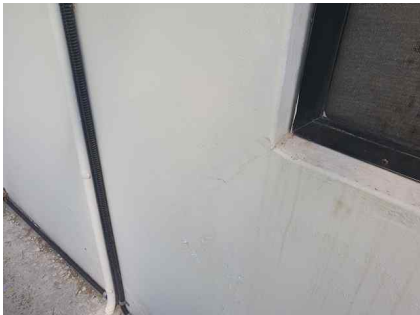
<계단실 외부 측면 균열>
