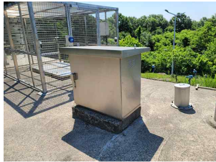
<외부 현장제어반 상태양호>
