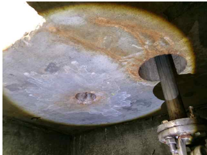
<유입밸브실 1지 상부슬래브 백태>
