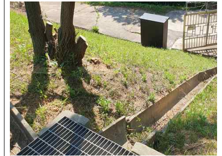
<부대시설 장내 배수지 상부 파손>
