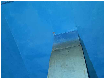
<배수지 1지 상부슬래브 녹>
